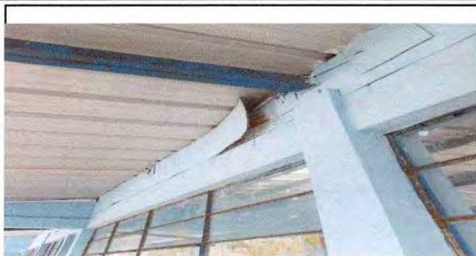
Foto19: Fisuras en muros
