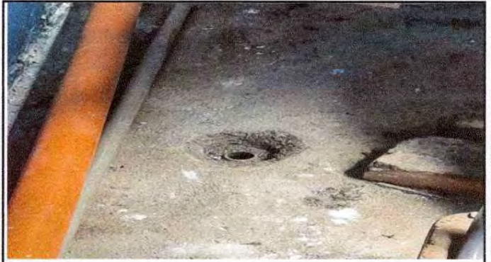
Foto 8: Red de drenaje (Sustitución de caja de registro)
